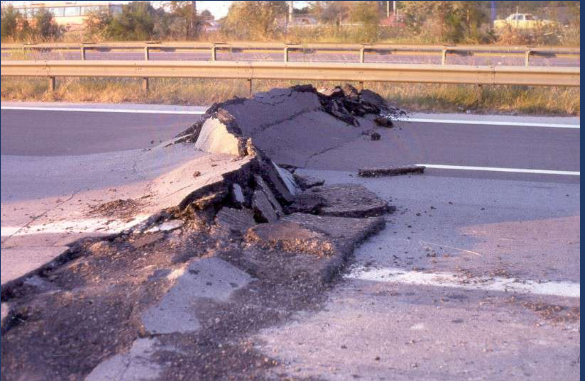
17 AĞUSTOS 1999 DEPREMİ YÜZEY KIRIĞI, SAPANCA GÖLÜ KUZEYDOĞUSU
